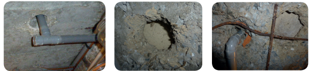
I Défauts d'étanchéité de réseaux dans la dalle du plancher sur cave
